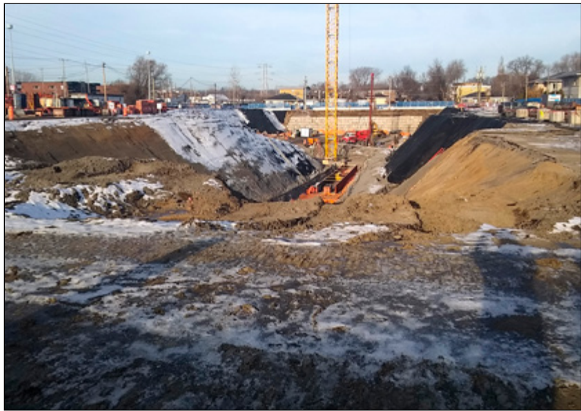
Les travaux d'excavation, de pieutage et de préparation se poursuivent sur le terrain du NCH.
